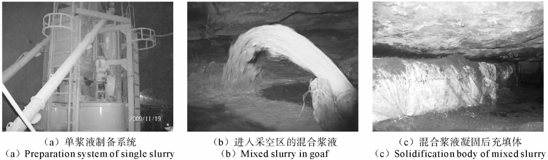
图 6 超高水材料浆液制备系统和采空区充填实照图
