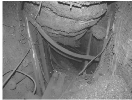
(b) 冲击矿压发生后巷道状况
