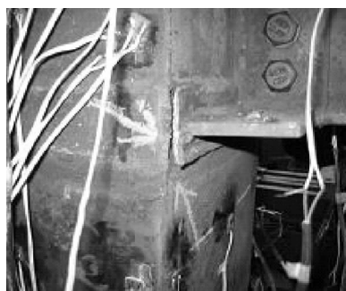
图 4 外环肋节点端部焊缝破坏图
